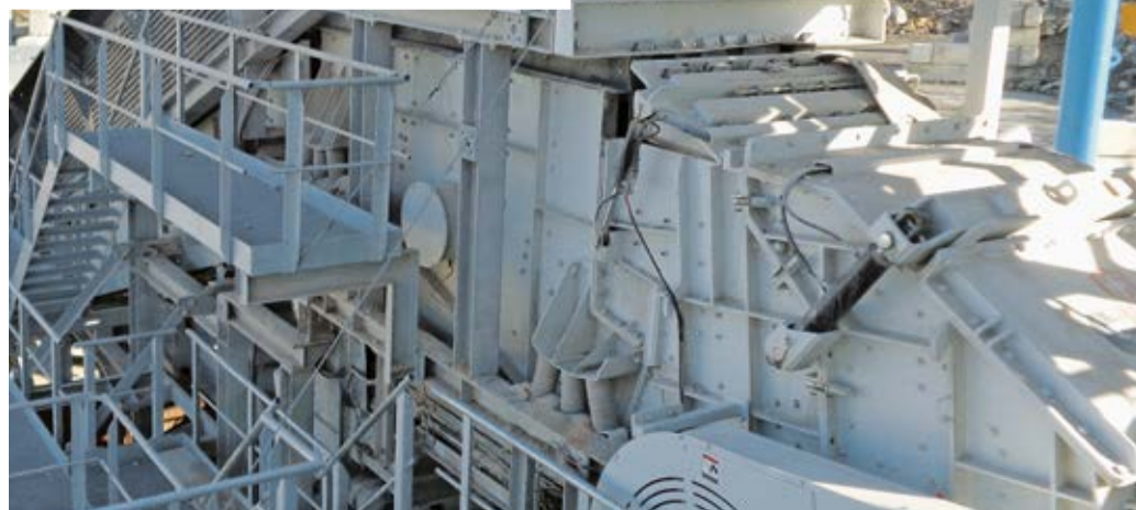
Installation de concassage fixe avec 129 points de graissage
